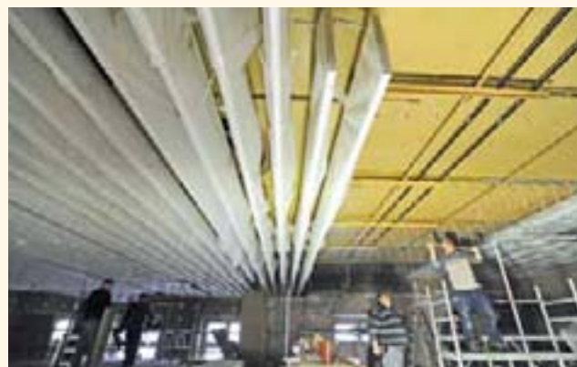
Zur Steuerung des Raumklimas wurden in die Decke des neuen Plenarsaals Kühllamellen eingebaut, durch die die goldene Decke hindurch schimmert.
