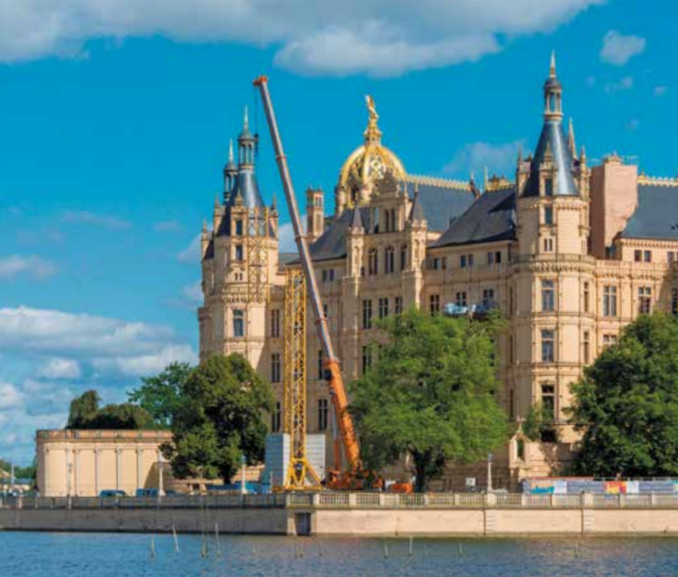
Stück für Stück wird der Baukran für den Abtransport in Einzelteilen zerlegt.
