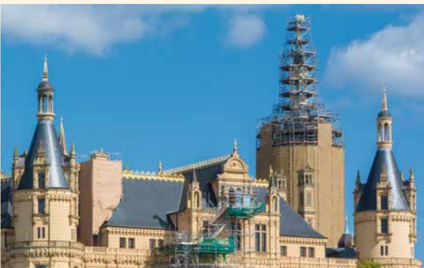
Schäden an Dach und Fassade des 70 Meter hohen Hauptturms des Schlosses werden ausgebessert.
