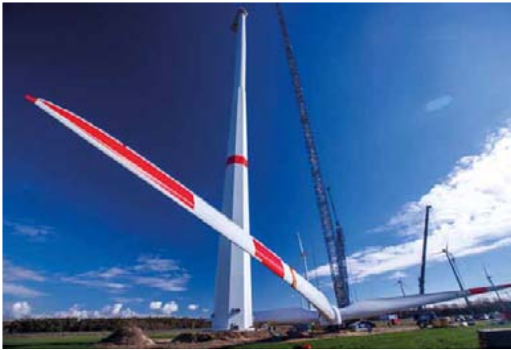
Mit Stromerzeugung mittels Windkraftanlagen soll wie hier an der Autobahn 24 südlich von Schwerin der Anteil der CO 2 -Emissionen reduziert werden. Foto: Jens Büttner
