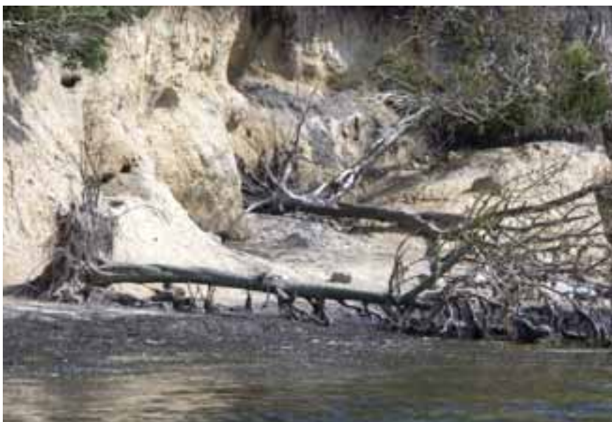
Die Sicherung von Steilküsten fällt in den Bereich der „Gemeinschaftsaufgabe zur Verbesserung der Agrarstruktur und des Küstenschutzes“.
